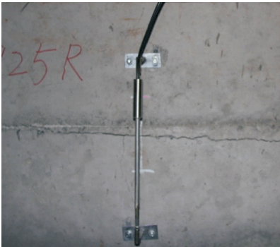
图 7 隧道内墙壁裂缝传感器
