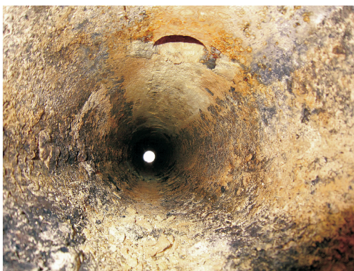
开孔接管处腐蚀情况现场检测图
