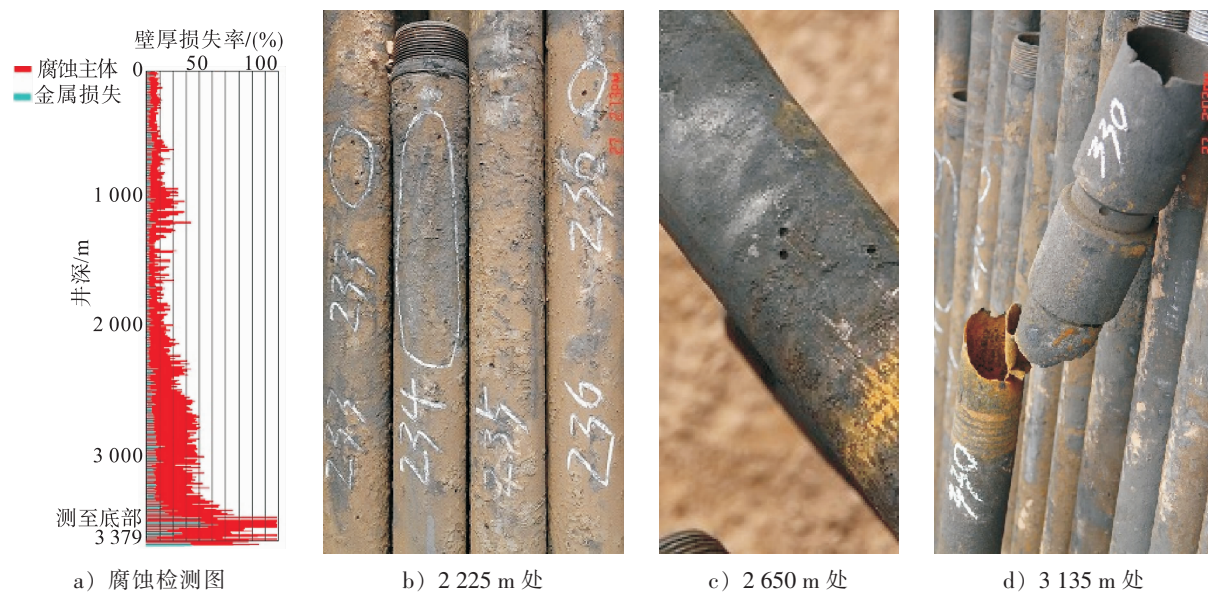
图 4 检测-06 井腐蚀检测图及油管起出后实物照片
