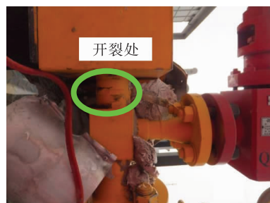
b) 现场开裂穿孔处
