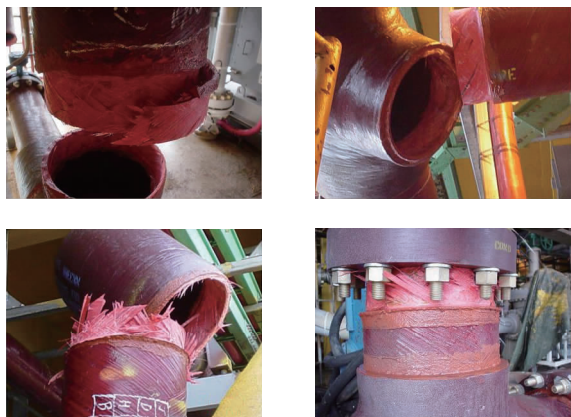
图 1 FRP 试压断裂
