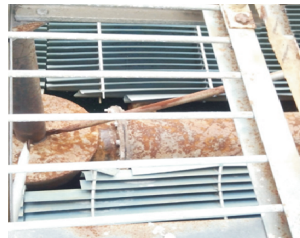
d) 内部钢结构腐蚀
