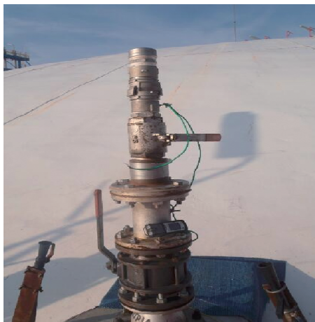
图8 阀组安装后实物
