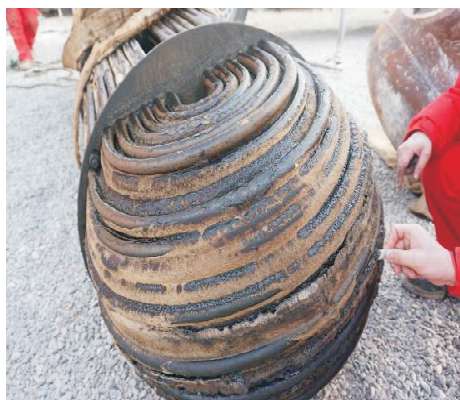
图 2 管束外壁盐堵照片
