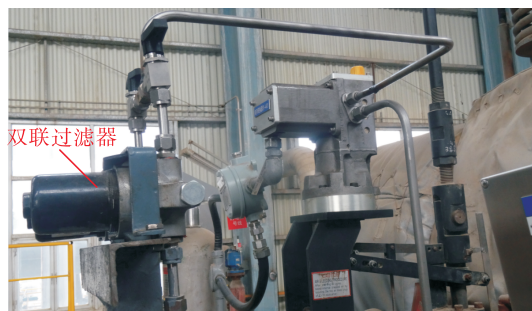
图5 双联过滤器照片
