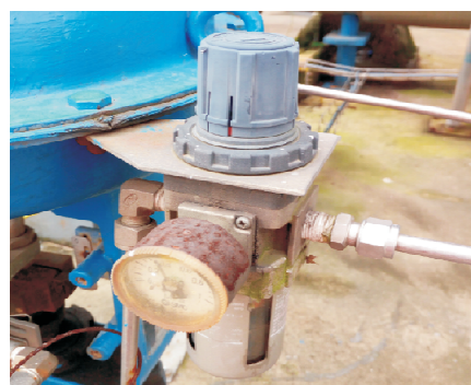
d) 过滤器老化堵塞
