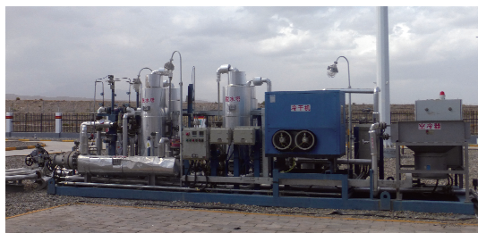
图2 可再生天然气脱汞装置现场照片
