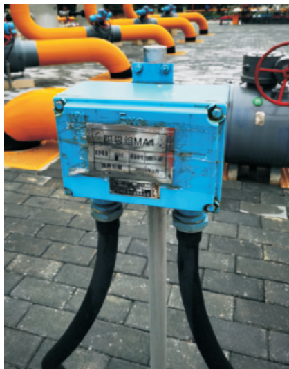
图 1 站内防爆接线箱照片
